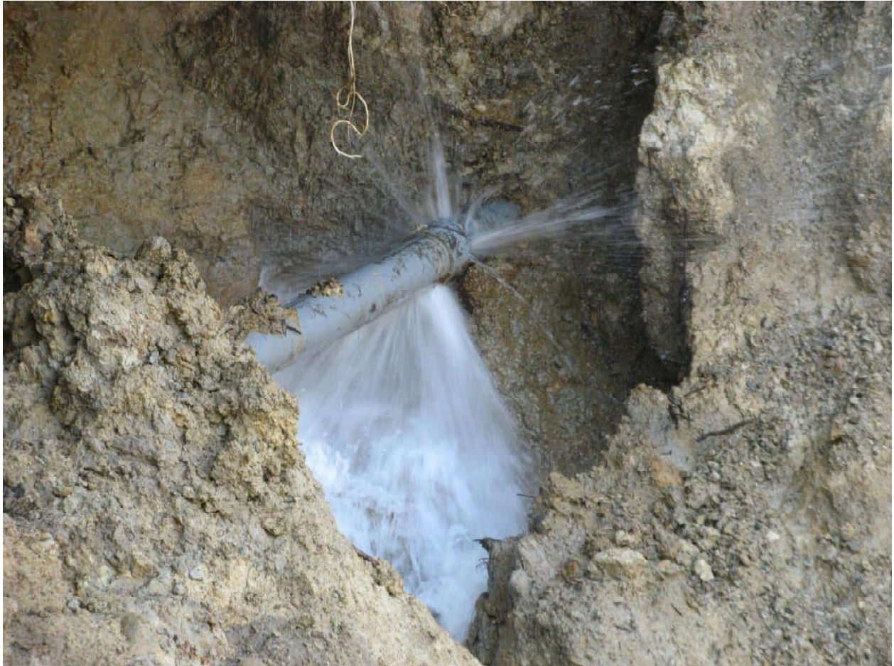
漏水写真(VP管)
